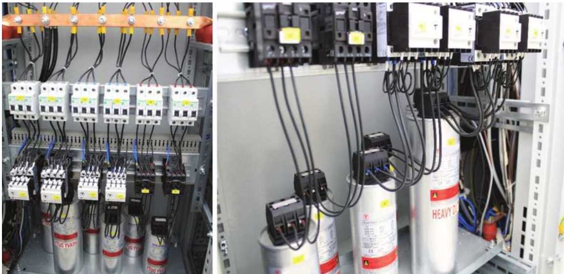
Görsel 11.7: Kompanzasyon panolarında kondansatörlerin bağlantısı
