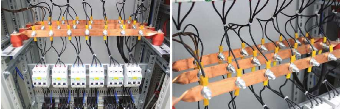
Görsel 11.6: Kompanzasyon panolarında kademelerin baraya bağlantısı
