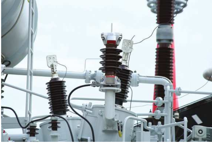
Görsel 12.19: Transformatör buşingleri
